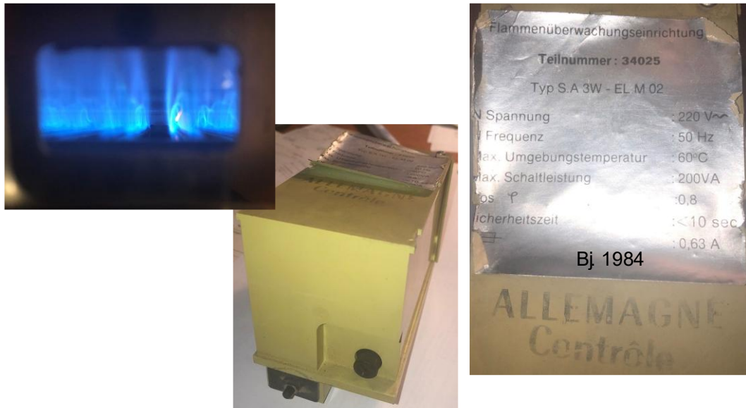
Bild 22 – Thermische Überwachungselektrode im Flammenbild (links) und Ionisationswächter (mitte, rechts)
