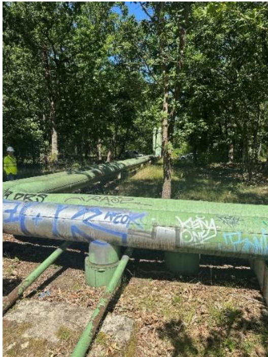
Bild B.4.1 – Fernwärme-Hauptversorgungsleitung
