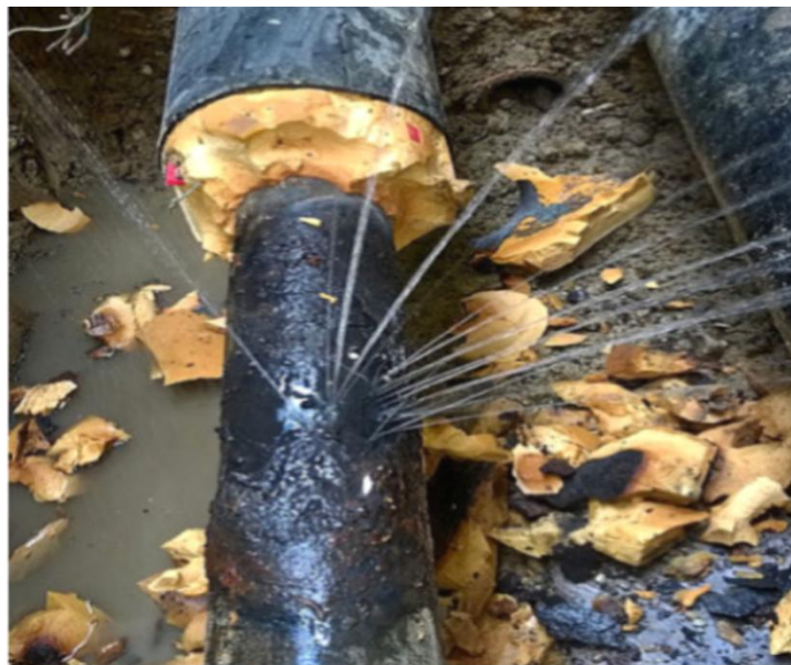
Bild 19 – Leckage in einem Fernwärmerohr im Straßenraum
