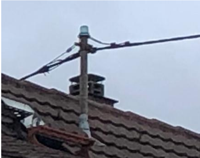
Dacheinführung mit isolierter Freileitung (Bündelleitung)
