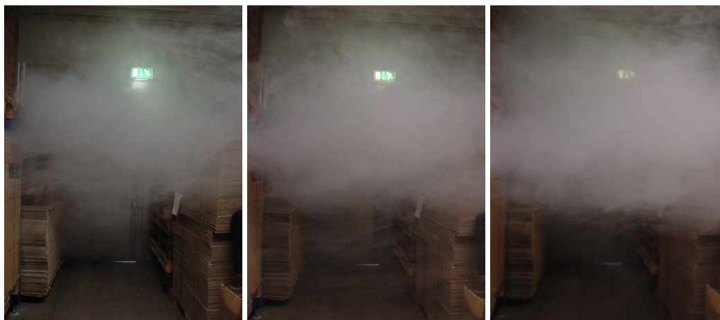
Rettungszeichen mit hoher Leuchtdichte nach DIN 4844-1 in dunkler Umgebung bei Verrauchung
