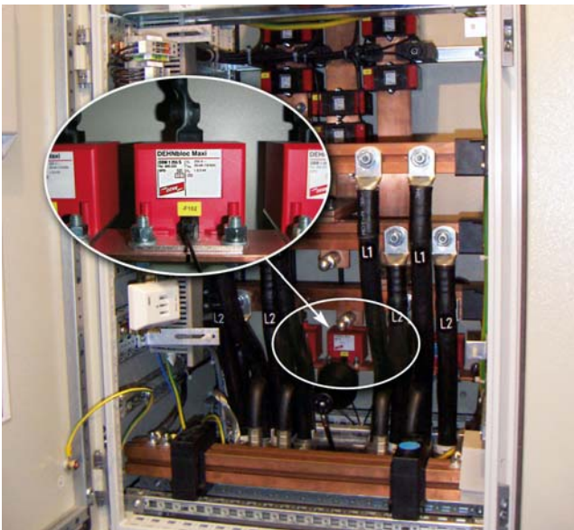
Bild 10 - Installation einer ÜSE n in einer Niederspannungs-Schaltanlage
