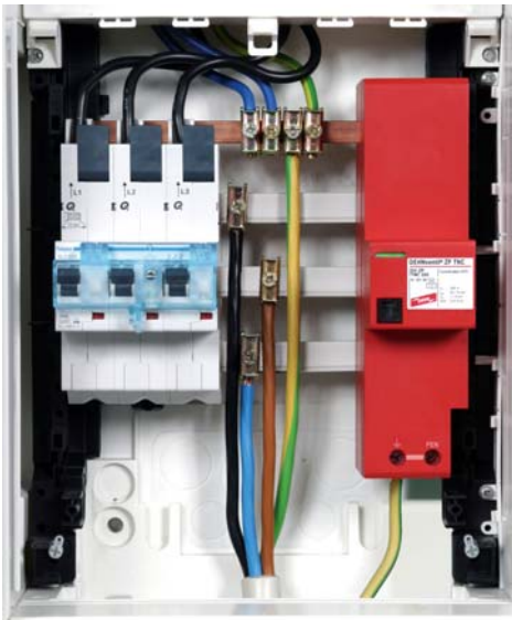
Bild 4 - Anschluss von ÜSE vom Typ 1 im Sammelschienen-Anschlussfeld des Zählerplatzes
